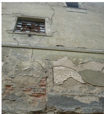
Plášť vykazoval statické poruchy
