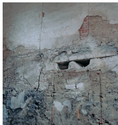
Zdegradované povrchy stěn vlhkostí a solemi v 1.PP
